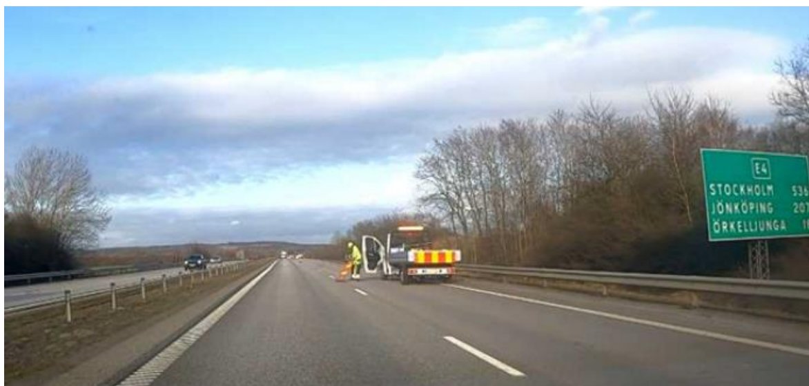
Exempel på kontroll som där anmärkningen klassats som: ”TMA saknas helt – personal på vägen”. TMA används inte vid etablering av arbetsplats på motorväg. Foto: Roger Persson.
