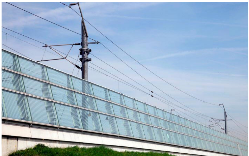
Bullerskydd och kontaktledningssystem är delar som bör ingå i gemensamma utredningar då de förekommer i stora mängder och påverkar sin omgivning. Bild från HSL Suid, höghastighetsjärnväg mellan Amsterdam och Bryssel.
