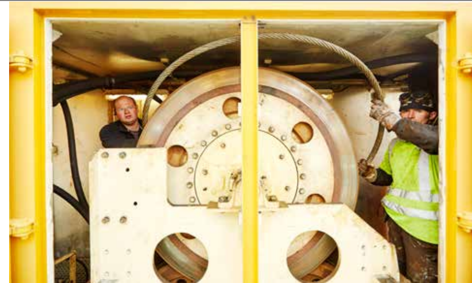
Christopher Wänerbris, distrikttekniker, och Krzysztof Koscielecki från Fridhems varv, hjälps åt att dra ut varjerna ur omegan. Lee-Flora tas upp på land för service och besiktning vart femte år.
