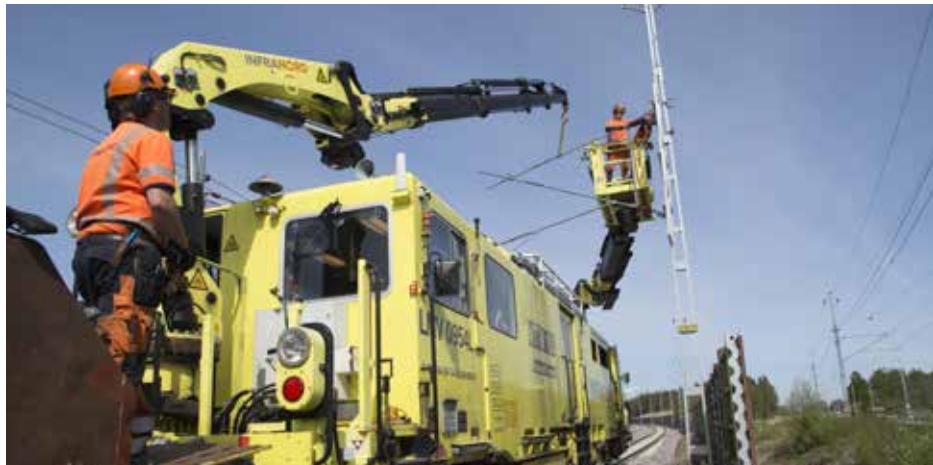
I mitten på maj pågick montering av kontaktledning på det nya dubbelspåret. I liftkorgen står Thomas Nyman och John Hedlund, lyftkranen styrs av Fredrik Wahlström.
