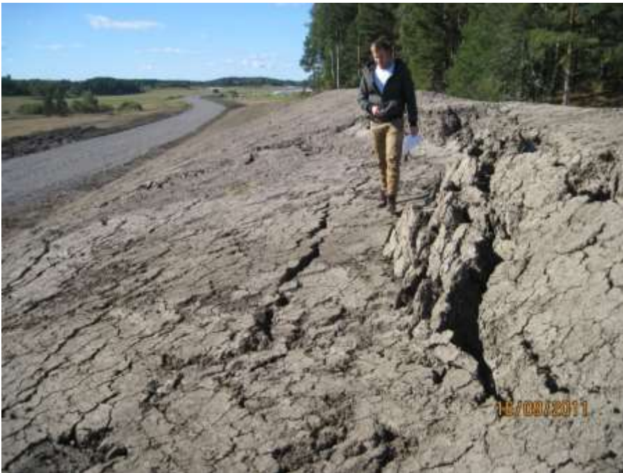
Figur 3. Skred i bullervall under byggtiden. Skredet skedde i själva bullervallen som var uppbyggd av omrörda lermassor. Inga rörelser skedde i undergrunden.
