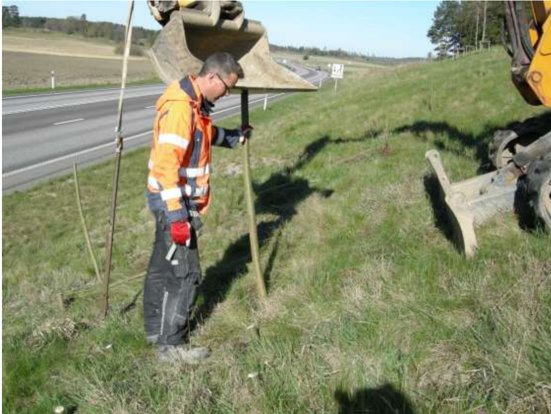
Figur 13. Installation av stickling med hjälp av grävmaskinsskopa. Spett för prylning av hål hänger till vänster om personen på bilden.
