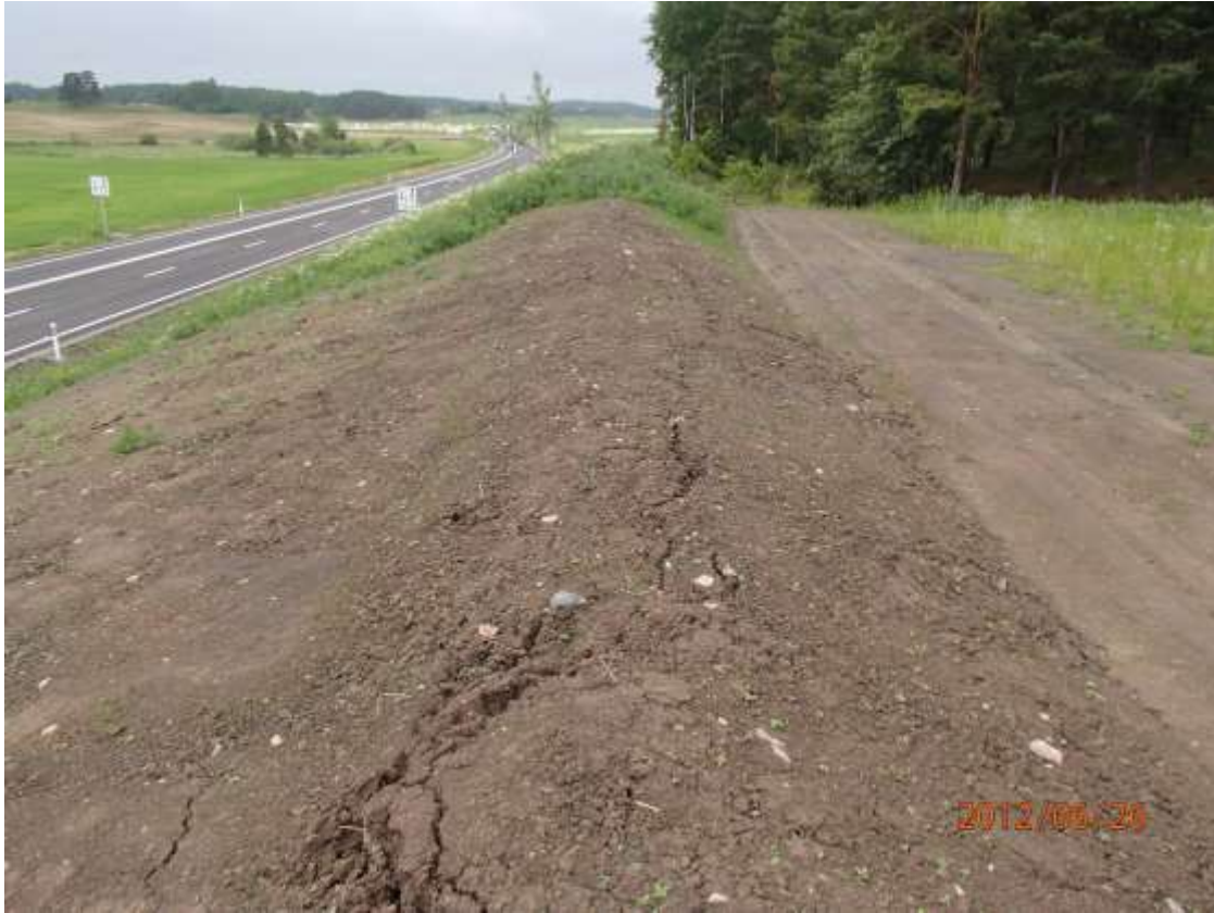
Figur 9. Flera mindre rörelser efter uppbyggnaden av bullervallen. Överst i september 2011 och nederst efter restaurering i juni 2012.
