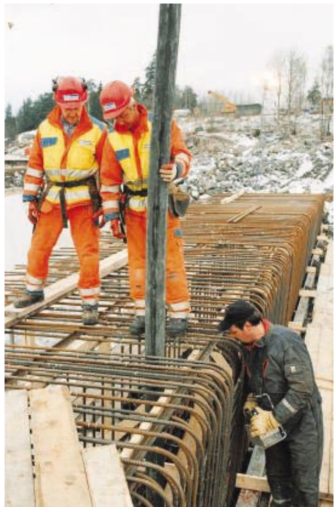
Under 1998 göt Vägverket Produktion Europas första bro i vibrationsfri betong. Metoden innebär stora fördelar för arbetsmiljön.
