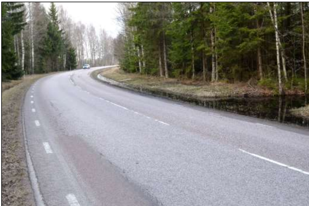
Foto 2. Väg S720 vid Almar. Dikena på östra sidan är vattenfyllda (2015-04-01).
