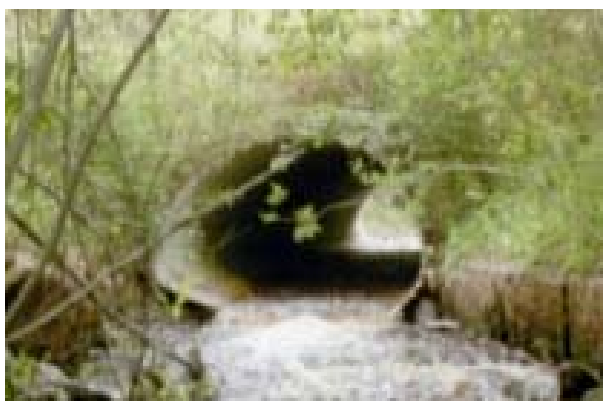
Vägtrumma i Hedvassla, före åtgärd
